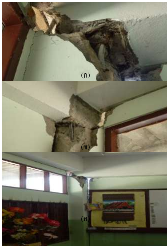
รูปที่ 1.2 ความเสียหายบริเวณคอเสารับคานชั้น 2 ของอาคารเรียน
